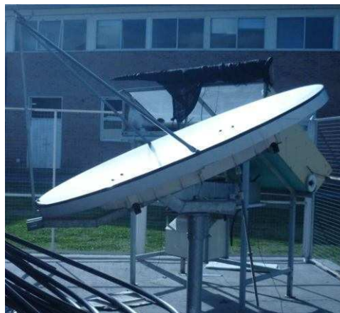
Figura 5. Vista general de los mecanismos de movimiento de la pantalla
