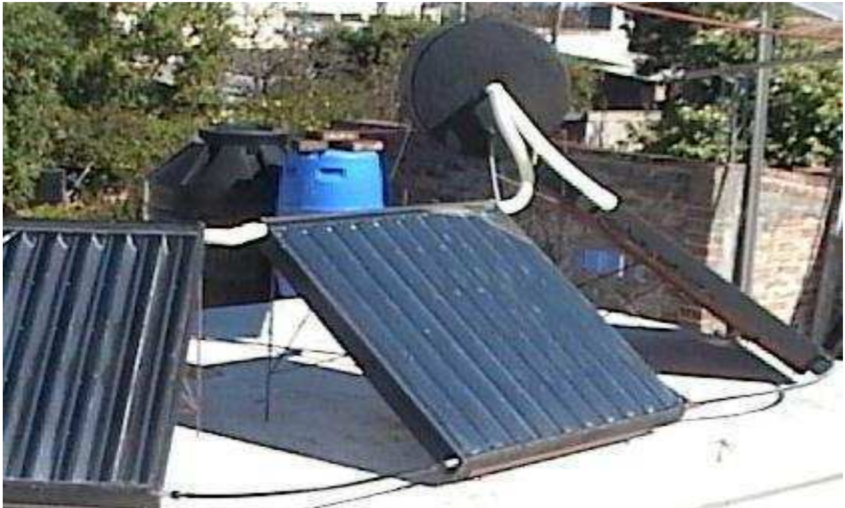
Figura 5: Colectores en funcionamiento para Agua Caliente Sanitaria domiciliaria
