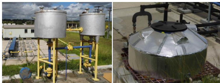
Figura 2 À esquerda tanques de óleo e a direita tanque de água gelada
