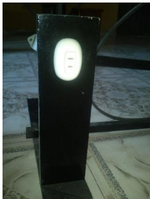
Figura 5: Enchufe hembra con los cables de salida del generador eléctrico acoplados.
