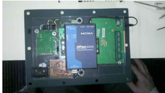
Figura 11 : Alojamiento del sistema de control electrónico
