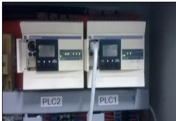
Figura 7. PLCs de la celda de manufactura flexible.
