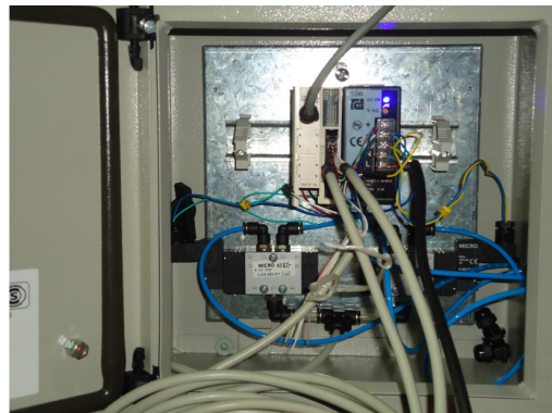
Figura 10 Interior del gabinete estanco
