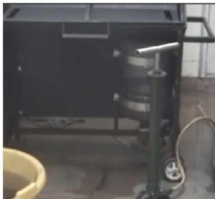
Figura 5: Sistema de bombeo de agua
