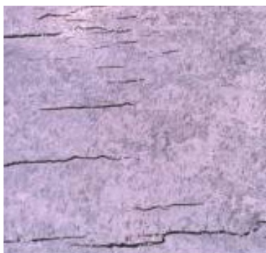
Figura 2: Defecto plano del tipo colonia de fisuras
