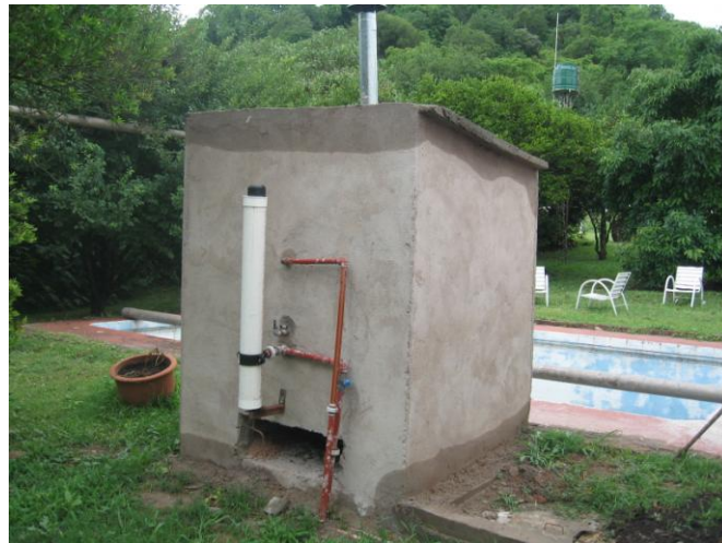
Figura 9. Caldera de biomasa para calefacción
