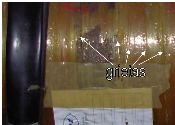
Figura 2: Grietas observadas en cilindros de GNC Tipo 2, en condiciones normales
