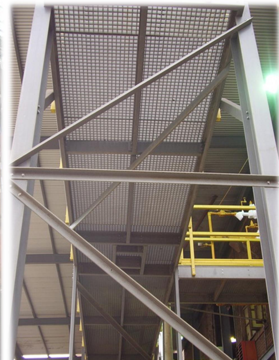
Planta de Lixiviación Estructura realizada completamente en Material Compuesto con Fibra de Vidrio
