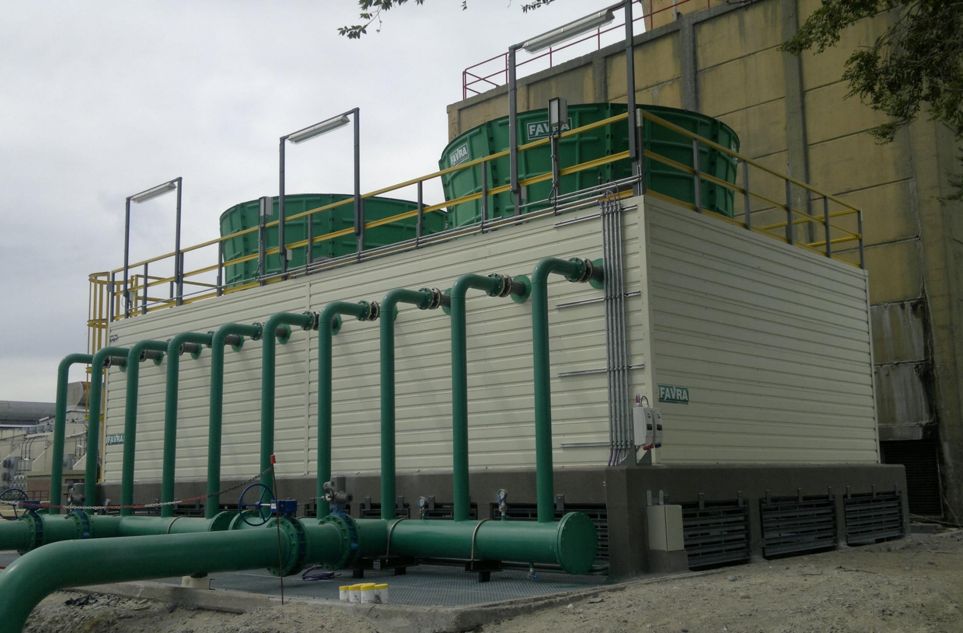
TORRE DE ENFRIAMIENTO - ALUAR
