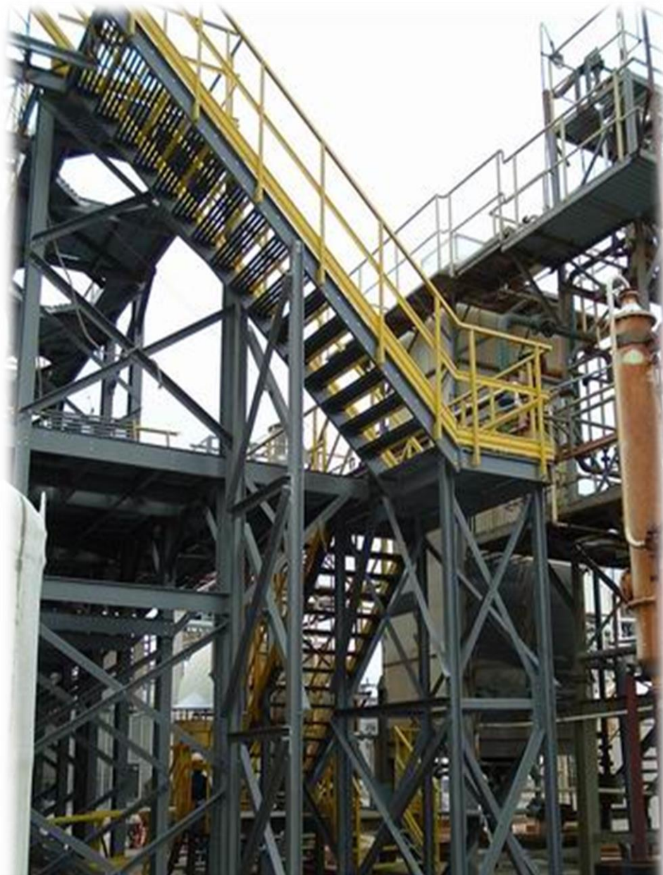
Planta de Hipoclorito de Sodio Estructura realizada completamente en Material Compuesto con Fibra de Vidrio
