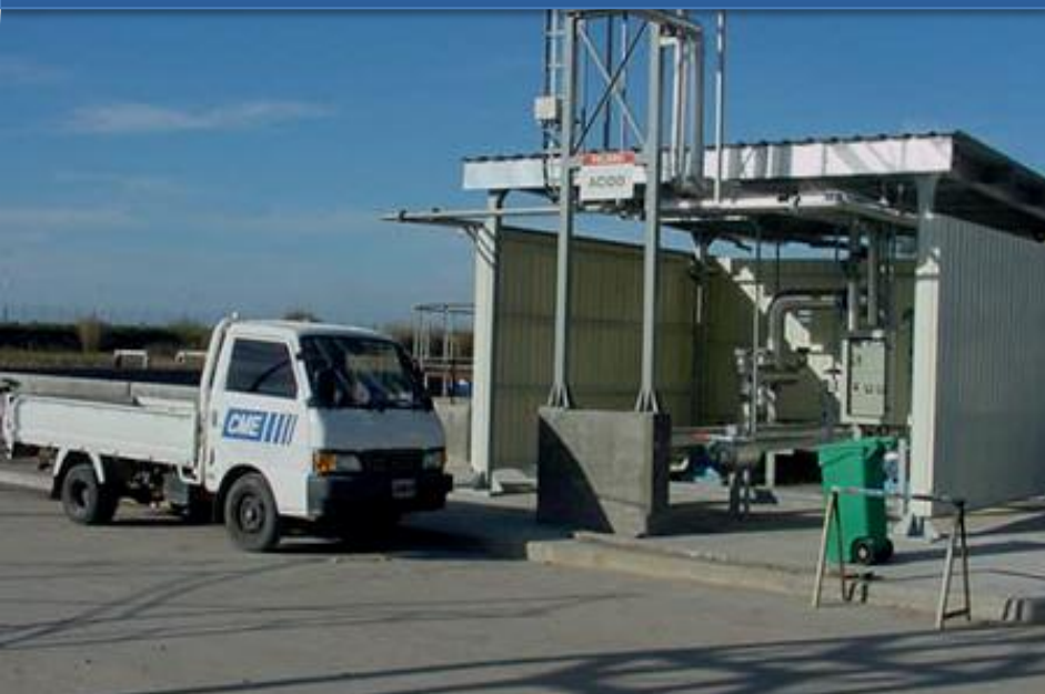
CERRAMIENTO DE BOMBAS ACÉTICO PLANTA BARADERO
